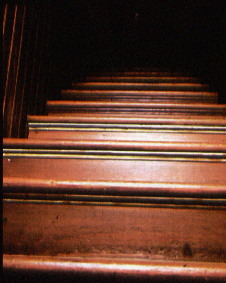
06 · ESCALERAS QUE TERMINAN CONTRA EL TECHO
